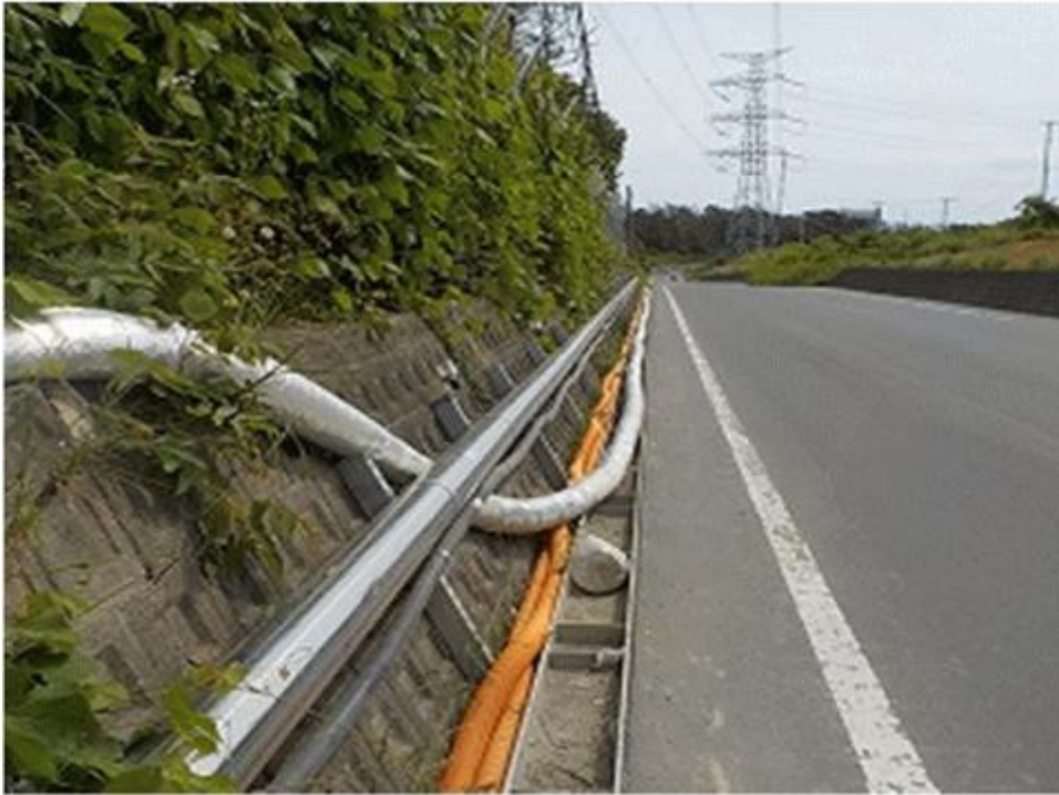
図一5 茅（ちがや）の中に放置され汚染水漏れを起こしそうなホース
