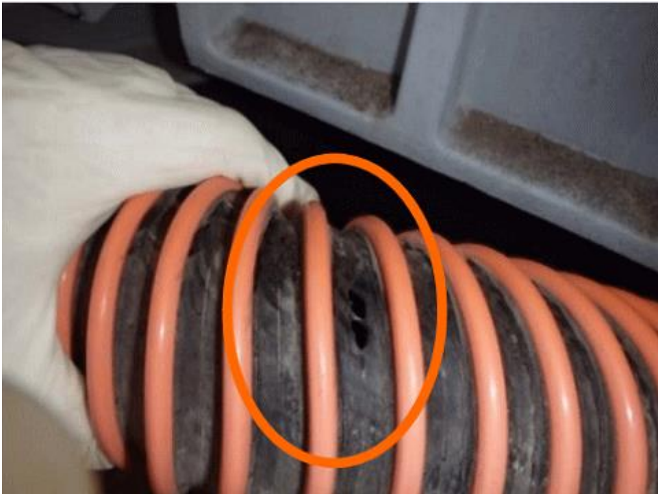
図一 4 汚染水漏れを起こしたホースに空いた「穴」
