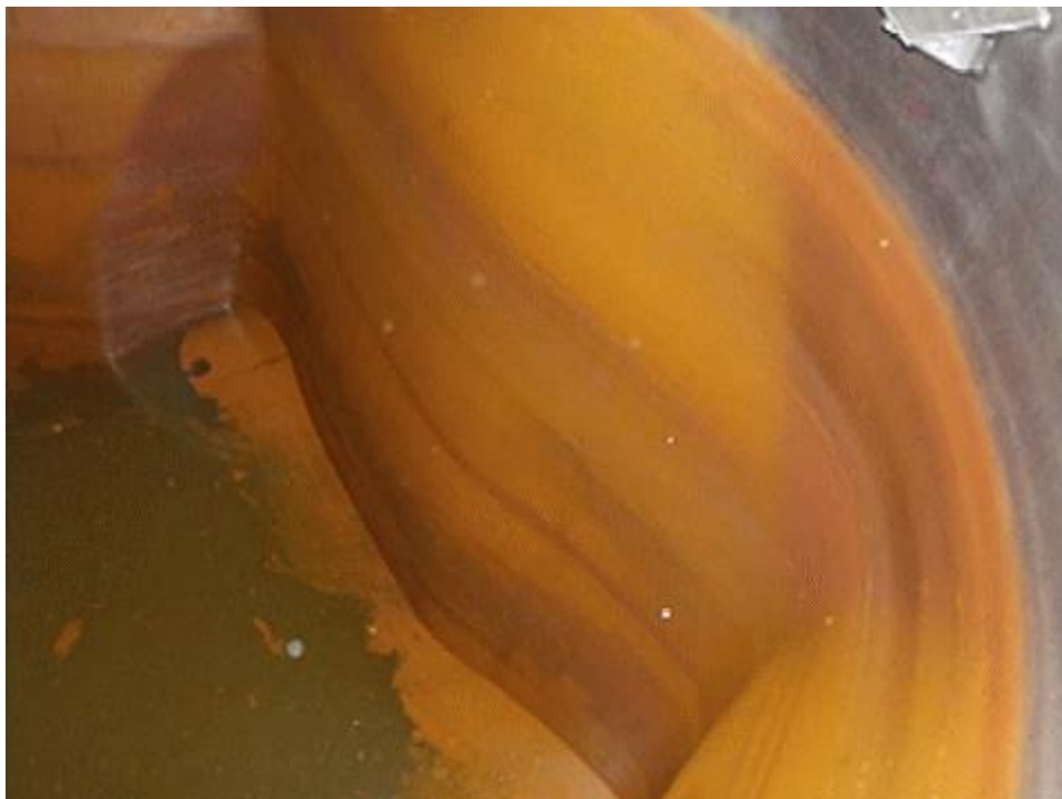
図一 1 変形が見つかった3号機廃棄物地下貯蔵設備建屋内の汚染水タンク
